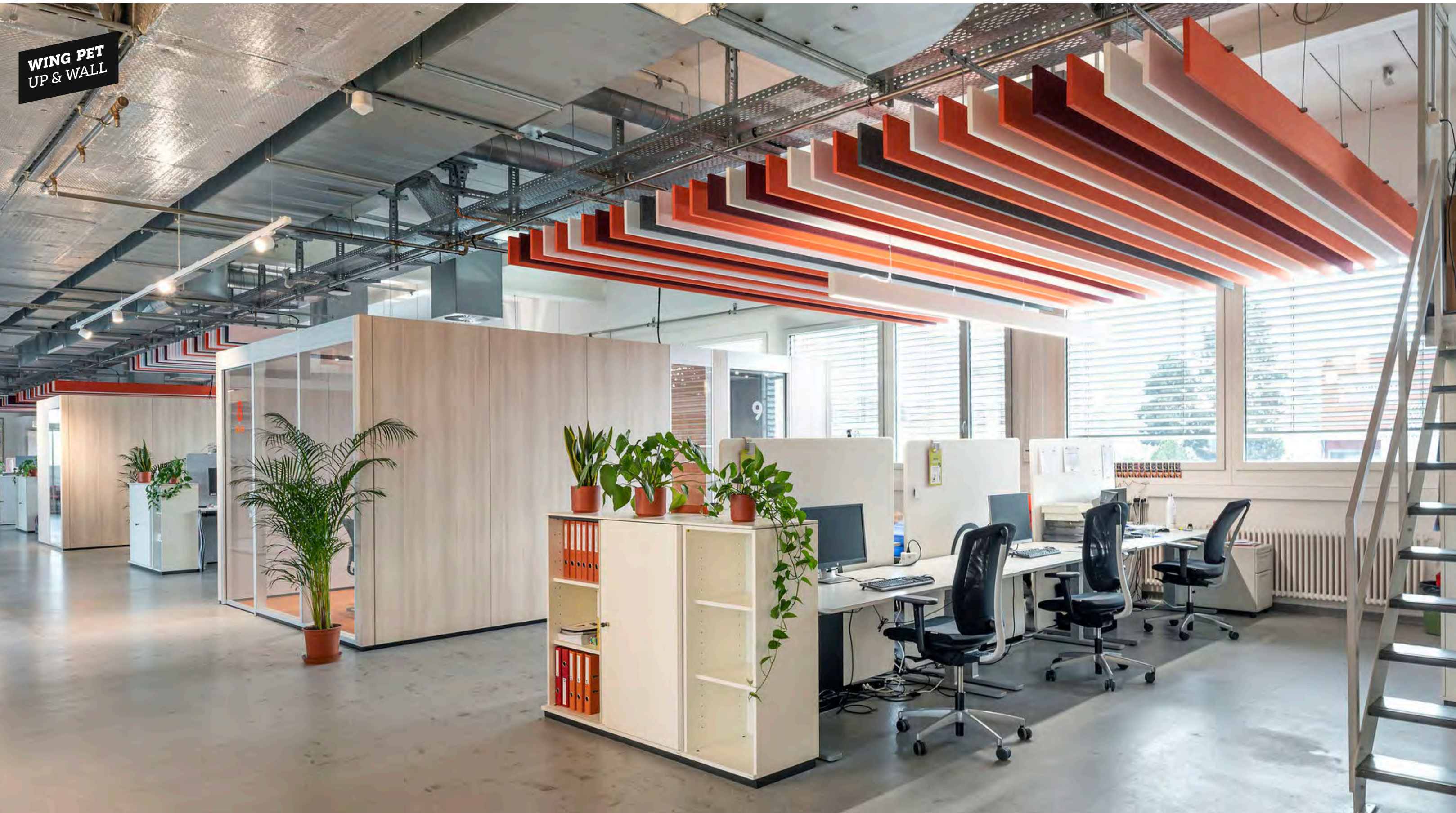
Deckenabsorber in unterschiedlichsten Formen und FARBEN umsetzbar - ob horizontal oder vertikal abgehängt.
